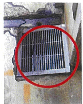
写真④グレーチング変形
