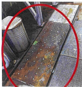
写真①②油水分離棟内の段差
