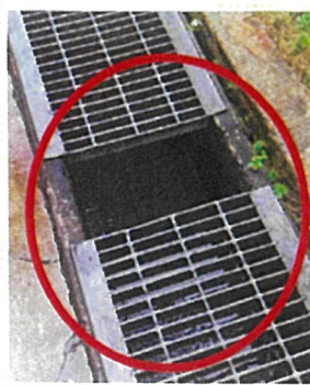
写真③グレーチング隙間
